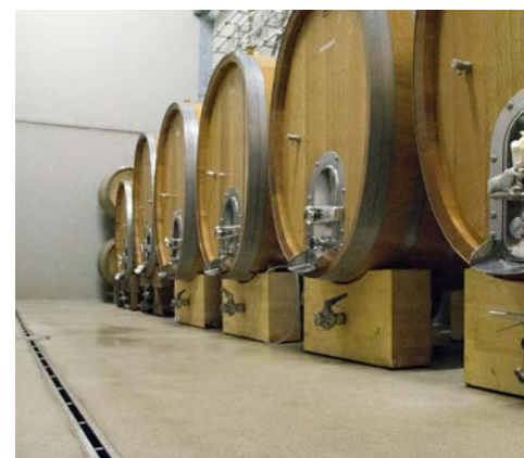
Perfekte Kellerhygiene dank nahtlos an Rinnen und Wände anschließender Spezialböden
